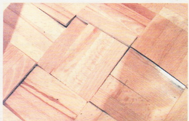
Platzt eine Wasserleitung, richtet das erheblichen Schaden an.
