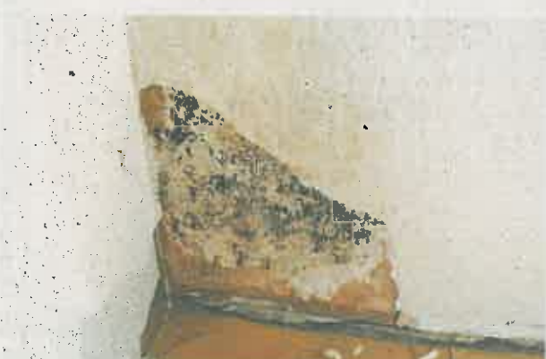
Fehlende Bauabdichtung kann zu erheblichen Schäden führen.
